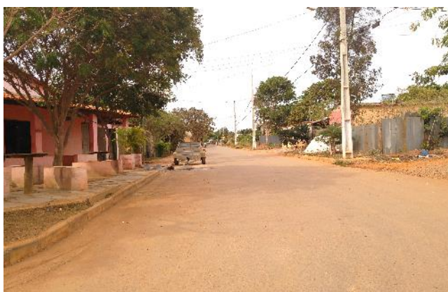
FIGURA 125: VIA SEM SISTEMA DE DRENAGEM OBSERVADO NA PORÇÃO CENTRAL DE ANGUERETÁ. FONTE: MYR PROJETOS, 2016.
