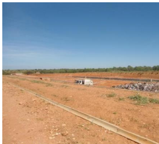
FIGURA 5. ÁREA DO ATERRO MUNICIPAL, COM CANALETAS DE DRENO. FONTE: EMS, 2015.
